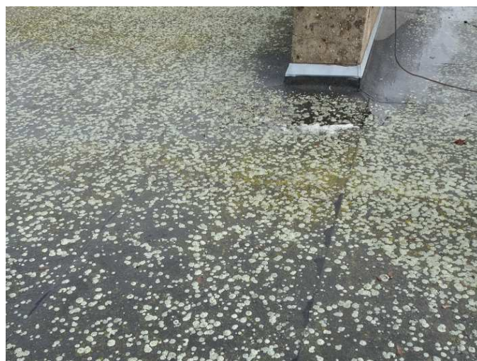
Pokrycie dachowe porośnięte algami i mchami
