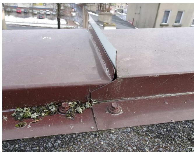
Niewłaściwy montaż obróbek blacharskich na niskiej attyce
