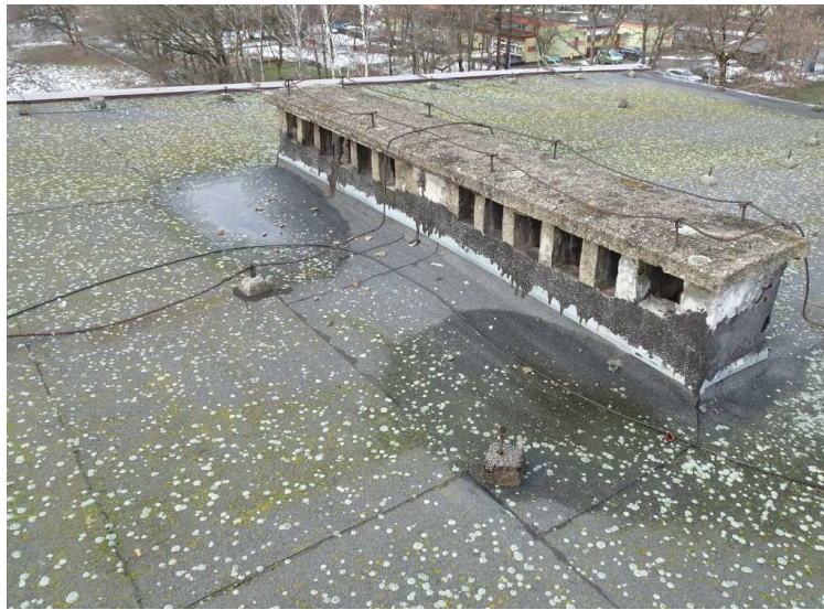
Instalacja odgromowa w złym stanie technicznym do częściowej wymiany
