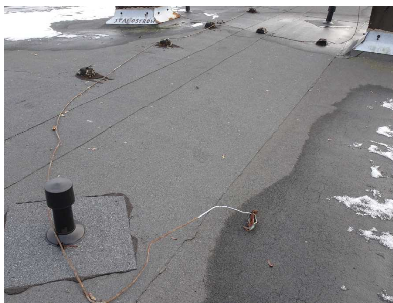
Instalacja odgromowa w złym stanie technicznym do częściowej wymiany
