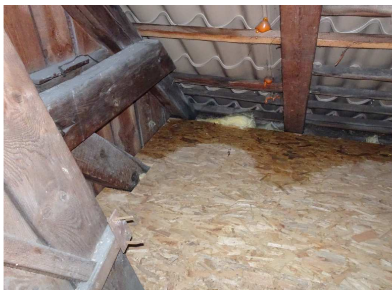
Zawilgocenia na poddaszu pod dachem z blacho-dachówki. Łaty i konstrukcja drewniana zawilgocona przez liczne przecieki
